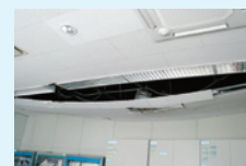
白河事業場の天井板落下
