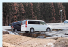
白河事業場の駐車場の液状化
