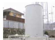
灯油タンク地上化
