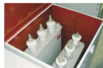
PCBの保管状況
